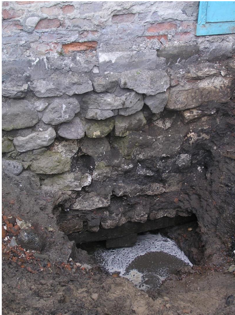
Рисунок 1.6 – Отсутствие раствора в бутовой кладке фундамента
