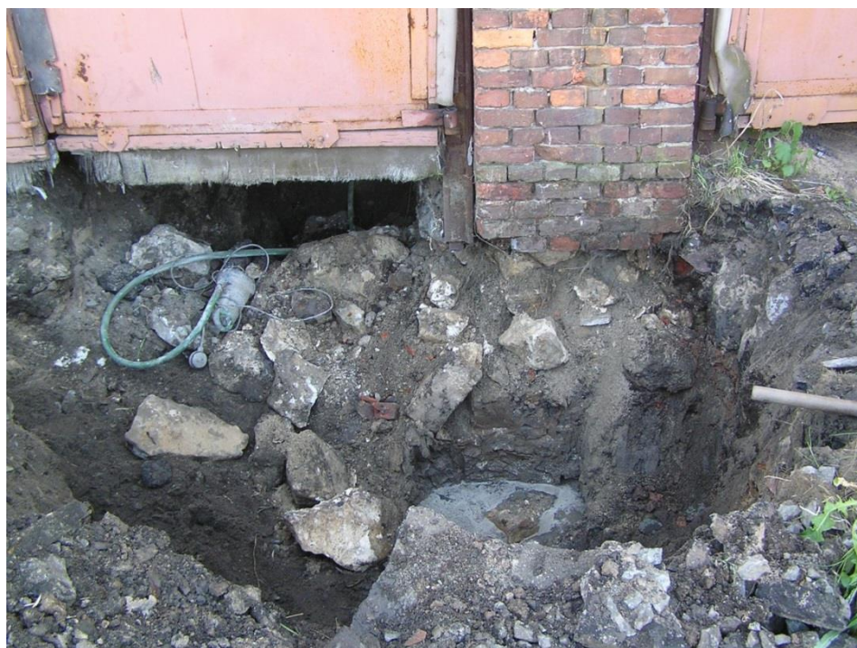
Рисунок 1.5 – Разрушение бутового фундамента
